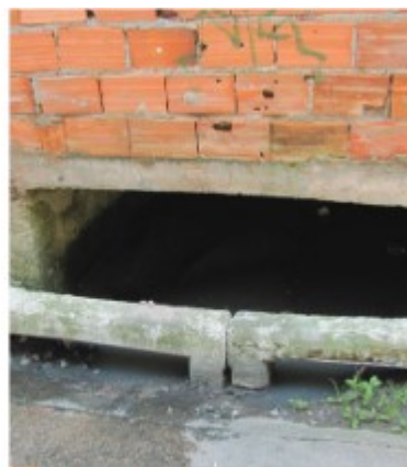
3 estrangulamento da canalização, local crítico de alagamento
