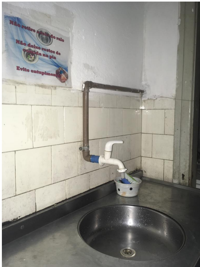
FOTO 2.2 Instalações hidráulicas lavanderia coletiva
