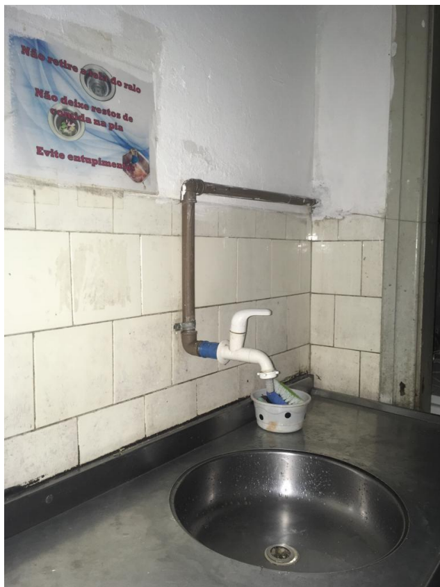
FOTO 2.2 Instalações hidráulicas lavanderia coletiva
